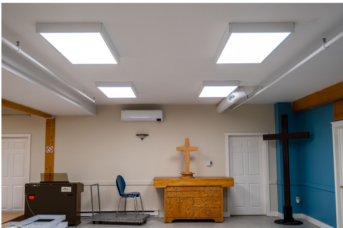
Des thermopompes et de nouveaux luminaires au plafond améliore la consommation d'énergie de l'église. Crédit: Jonathan Poirier.
