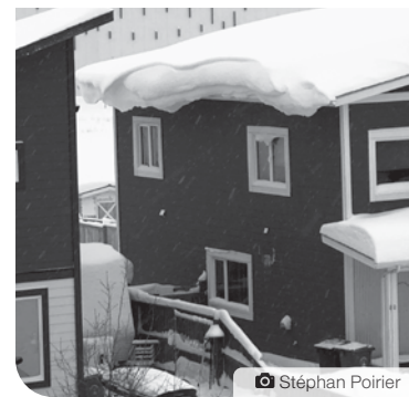
Une dangereuse corniche de toit à Whistle Bend.
