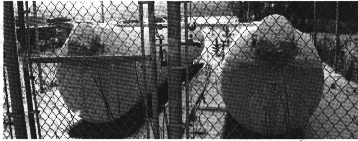
Les réservoirs de propane de l'école sont protégés par un grillage cadennassé.
