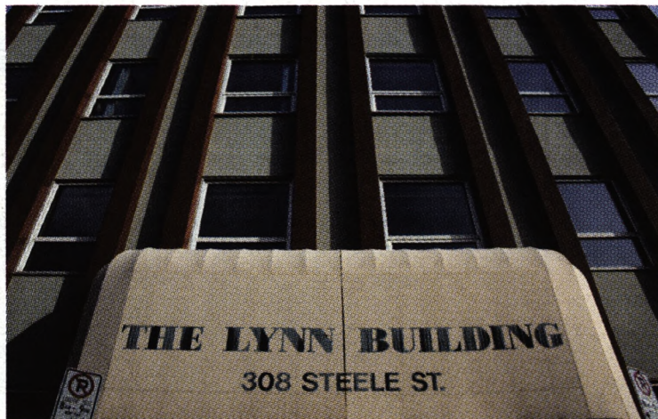
La façade de l'édifice Lynn, sur la rue Steel, a été fissurée et le bâtiment est fermé jusqu'à nouvel ordre.
