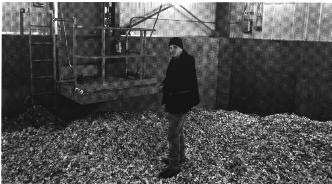
Mike Fraser dans le hangar où sont remisés les copeaux de bois qui alimentent la chaudière.
