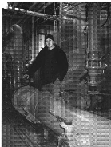
Photos : Christopher Scott. Acheminées par des aqueducs, les eaux potables de Dawson sont d'abord remises dans deux citernes chauffées par un système de biomasse.
