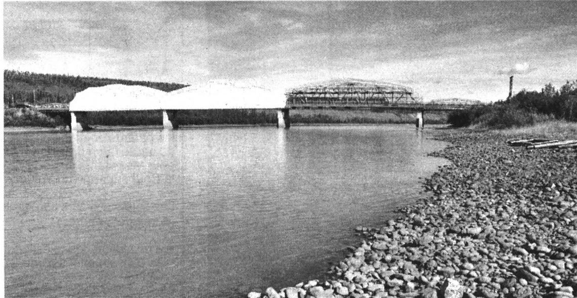
Le pont sur la rivière Pelly près de Pelly Crossing a été temporairement couvert pendant la durée des travaux de réfection.
