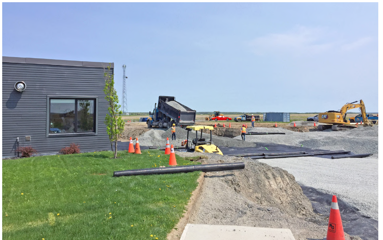
Le chantier de construction de la nouvelle aile du Témiskaming Lodge. Photo : Marc Dumont
