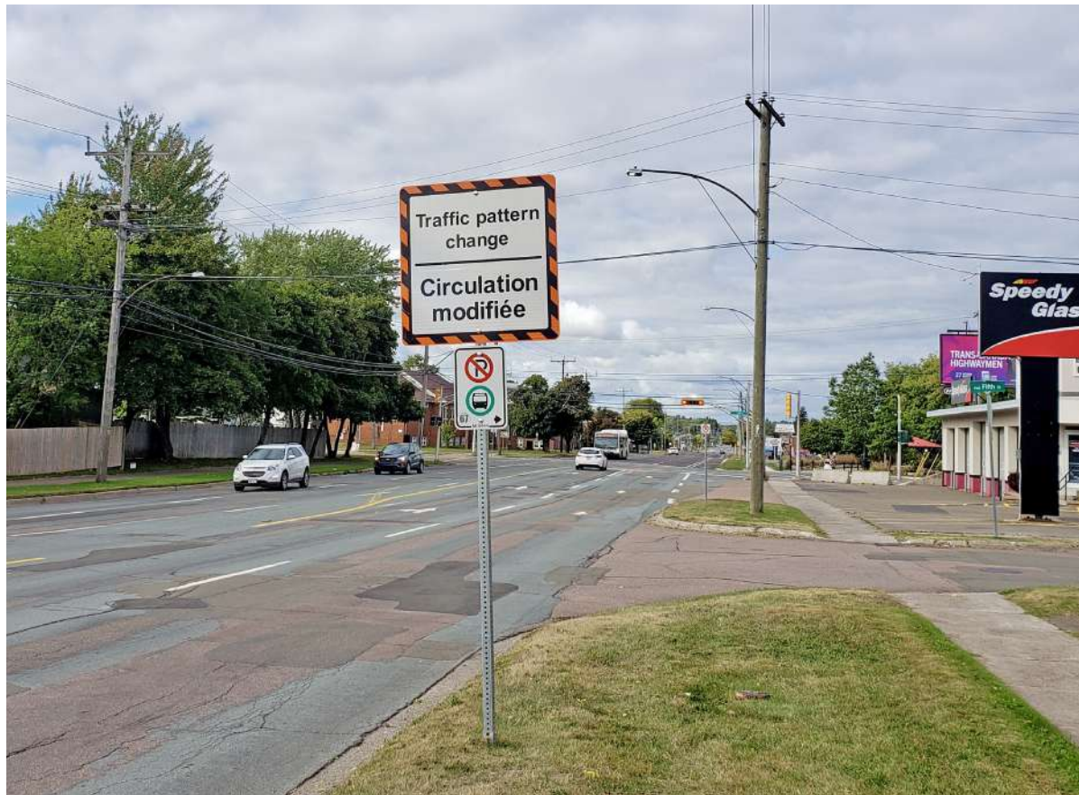
Le visage du boulevard St-George a quelque peu changé après des travaux qui ont duré tout l'été. Crédit : Damien Dauphin – Le Moniteur Acadien
