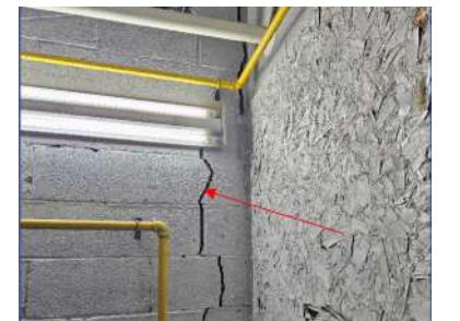
Fissure dans la salle de la surfaceuse.
