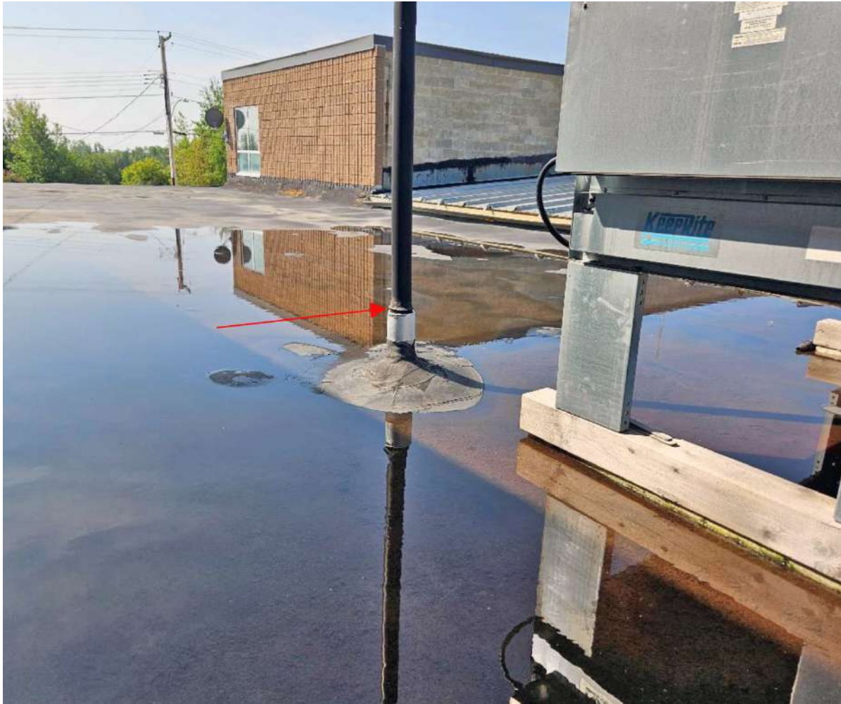
Accumulation d'eau sur le toit de l'aréna. Crédit : Canton de Hornepayne
