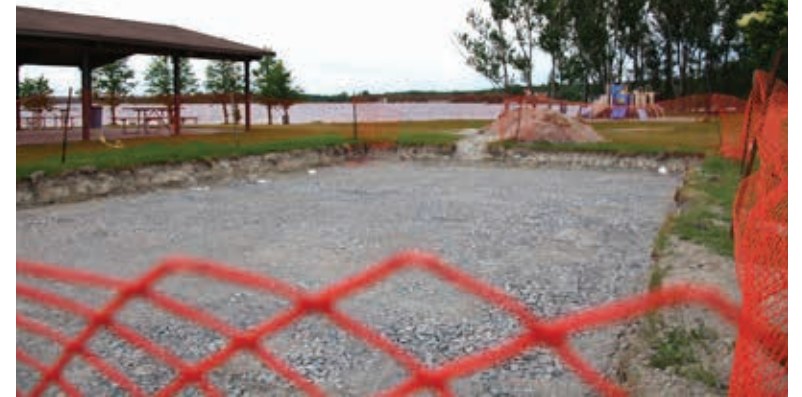
Le site de construction des jeux d'eau au parc Whitewater à Azilda. — Photo : Julien Cayouette
