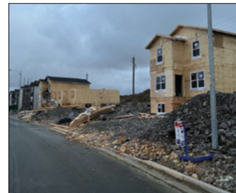
De nouvelles maisons sont construites à Kenmount Terrace à St. John's. Un grand nombre d'étudiants cherchent à se loger dans ce quartier. Photo: Kelsey Dwyer
