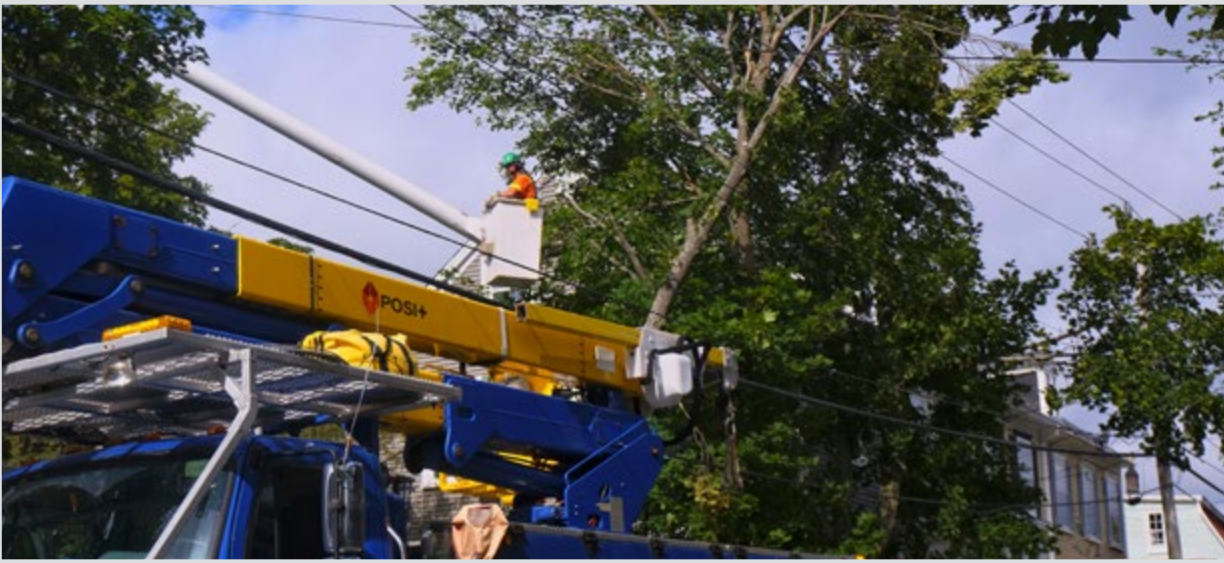
Avec environ 60 000 foyers sans électricité au lendemain de la tempête, les équipes de Newfoundland Power n'ont pas perdu de temps pour commencer les réparations. Une équipe dépêchée sur Monkstown Road retire d'énormes branches tombées sur les lignes électriques dans le quartier de Georgestown. Photo: Coline Tisserand
